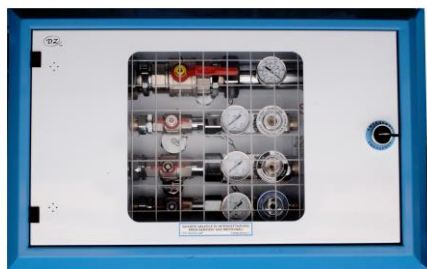
Quadro valvole con manometro e prese
