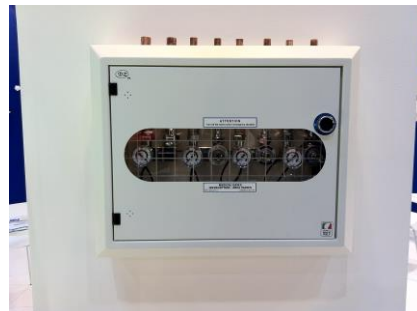
Quadro valvole con manometri con contatti pressostati
